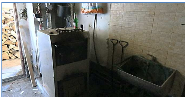
1NP kotel ÚT (objekt stojí na pozemku jiného majitele)
